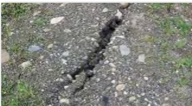
Figura 6. Grieta de tracción hallada en media ladera de la zona 4.
