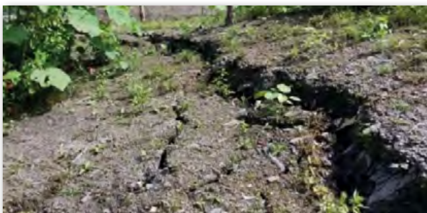
Figura 5. Grieta de tracción hallada en la corona de la zona 1.
